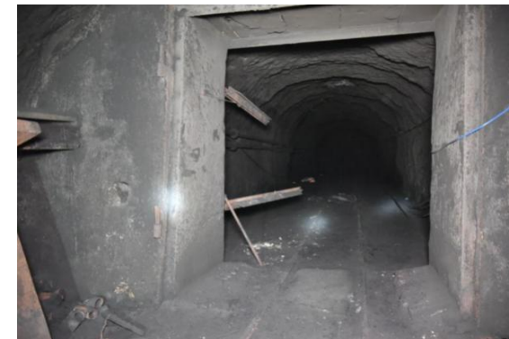
火风压冲开风门燃烧破坏情况
