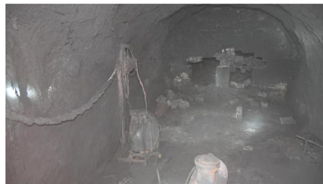
图3 控风墙墙体受损
