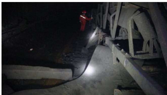
事故后下皮带断落到下方情况
