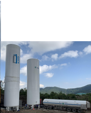
地面液氮储罐
