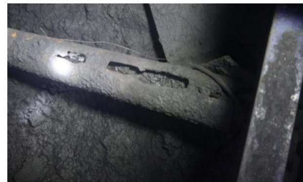
被磨穿沉积粉煤的回程托辊
